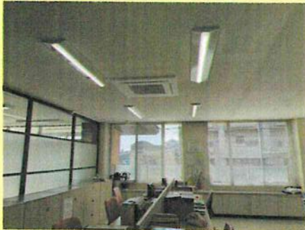
事務所内照明の LED 化
